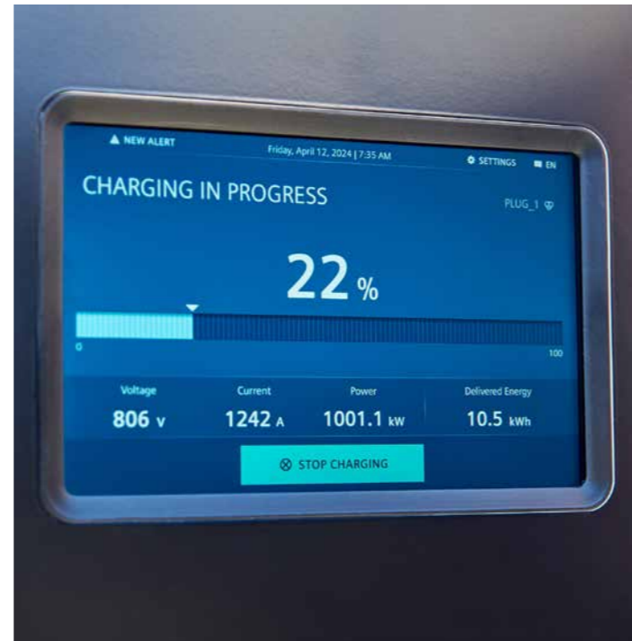
SIEMENS HAT MIT SEINEN LADEGERÄTEN das Megawatt-Laden bereits erfolgreich durchgeführt.
